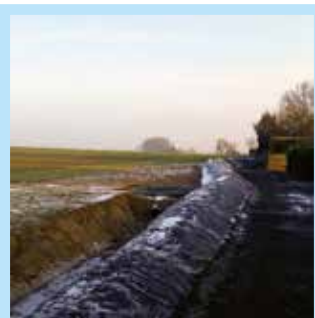
Rue du Merchin Le merlon est terminé. Bel ouvrage réalisé pour lutter contre les coulées de boue.
